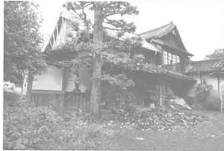
主屋正面、瓦が落下し土壁も剥落
