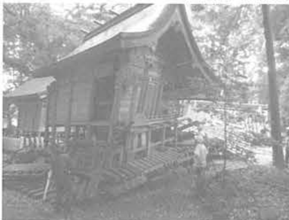
大きく傾斜した本殿と倒壊した拝殿
