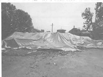
本震で倒壊した建物を応急的にシート養生
