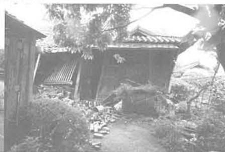
主屋裏、柱が著しく傾斜し土壁も剥落
