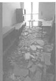
木摺天井材の落下
