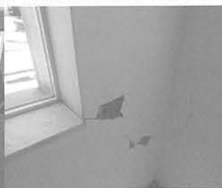
外壁のクラック
