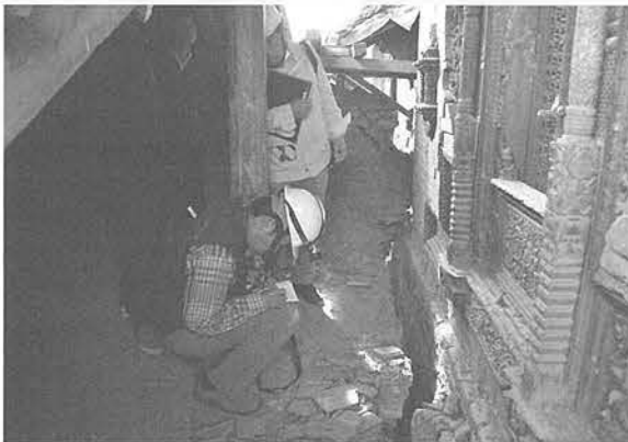
写真3 ハヌマンドカ王宮内での破損調査
