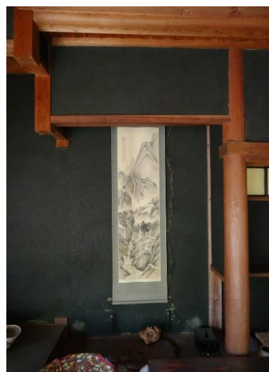
写真 3.2.30 矢野家住宅（新宅）・トコ壁の亀裂
