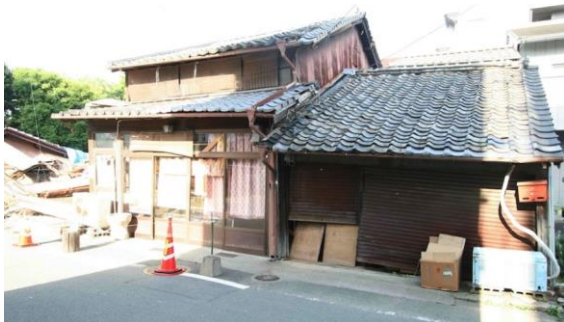
写真 3.6.25 倒壊した町屋と棟続きの建物は大きく傾斜
