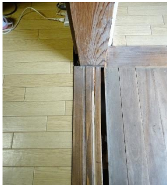
写真 3.2.22 矢野家住宅（本宅）・主屋 敷居のズレ
