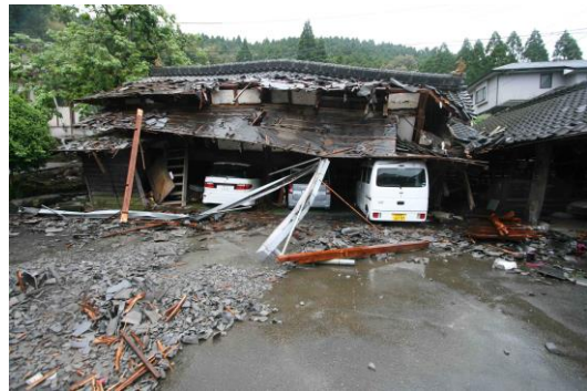
写真 G.10 倒壊した建物が車に載った状況
