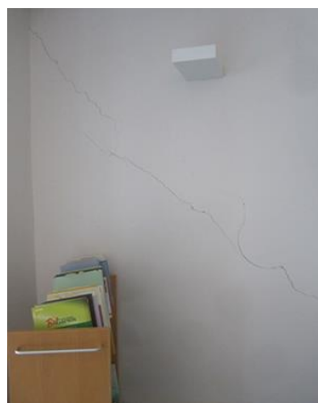
写真 3.4.4 壁面のせん断ひび割れ
