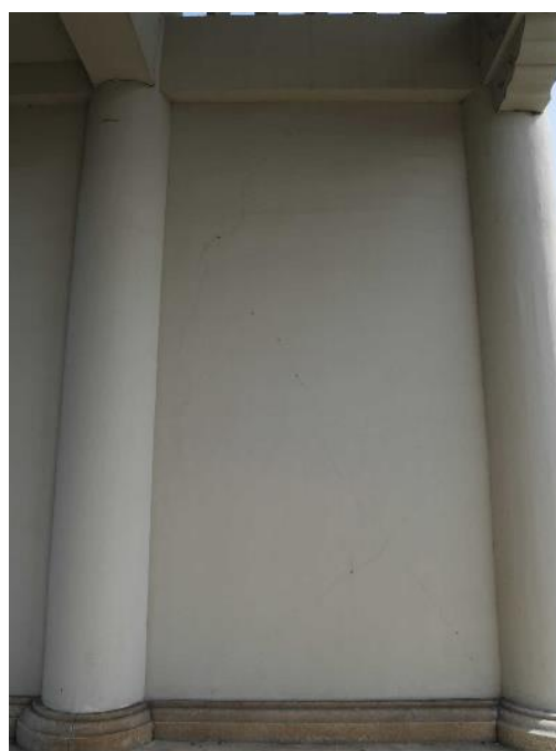
写真3.4.10 本妙寺仁王門・壁のせん断ひび割れ
