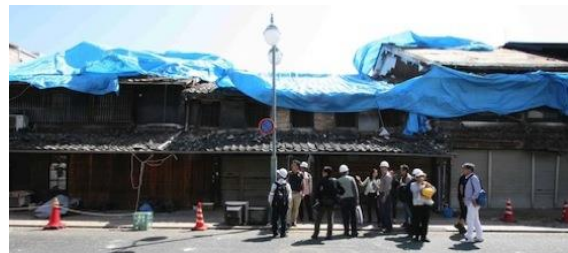
写真 3.6.28 古町地区の歴史的建造物の被害と調査団
