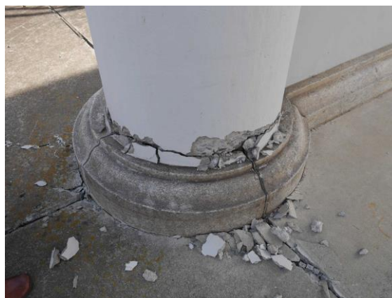
写真3.4.9 本妙寺仁王門・柱脚の破損
