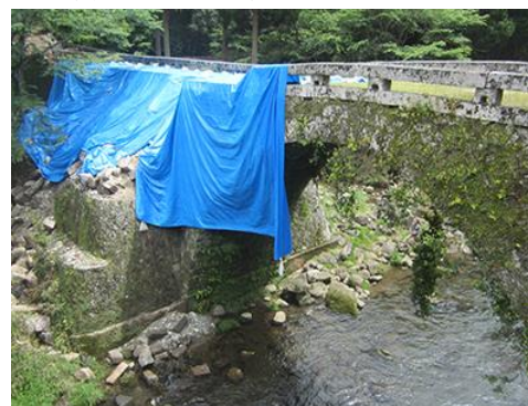
写真 3.3.8 八勢眼鏡橋の崩落(上流側から)
