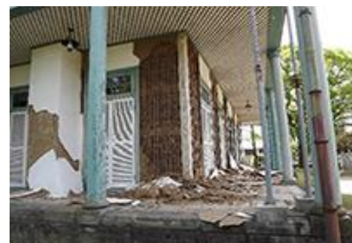
写真 3.3.12 前震による被害状況(正面左)
