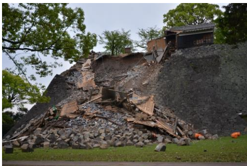
写真 G.2 北十八間櫓の崩落
