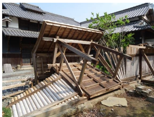
写真 3.2.19 矢野家住宅（本宅）・中の門の倒壊
