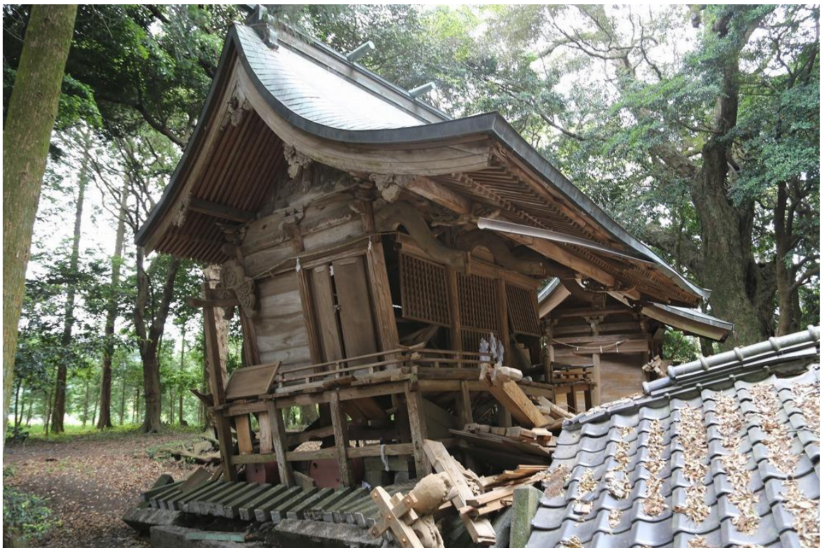
写真 G.7 大きく傾斜した本殿と倒壊した拝殿
