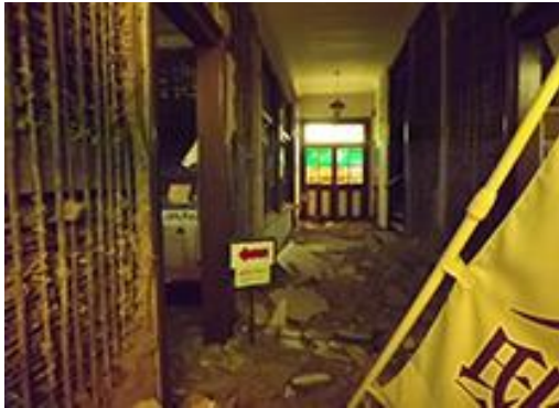
写真 3.3.13 前震による被害状況(内部)
