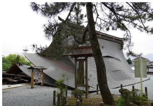
写真 3.3.2 阿蘇神社・倒壊した楼門(境内側)
