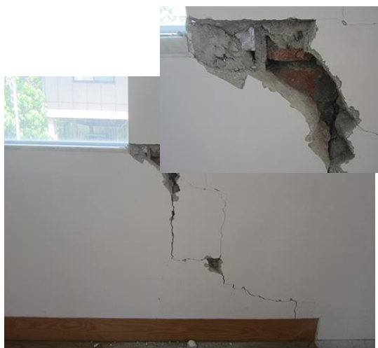
写真 3.4.3 開口部に生じたひび割れ
