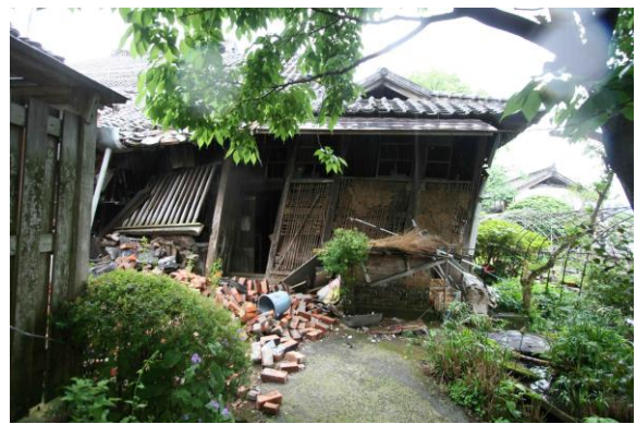
写真 G.4 主屋裏、柱が著しく傾斜し土壁も剥落
