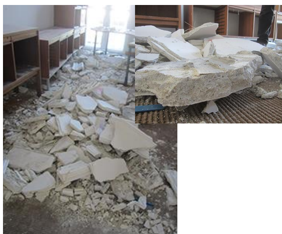
写真 3.4.5 木張り天井の漆喰の落下
