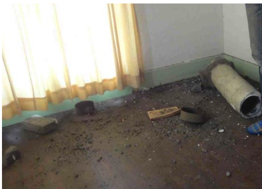
写真 3.5.2 煙突が脱落し、室内に落ち込んでいる
