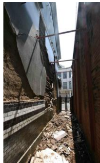
写真 3.6.8 煉瓦壁と接続した土壁が崩落
