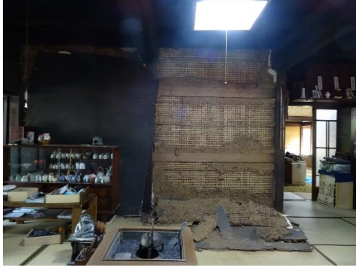
写真 3.2.20 矢野家住宅（本宅）・主屋 オモテの壁崩落
