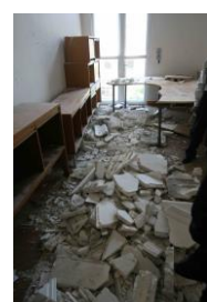
G.16 木摺天井材の落下
