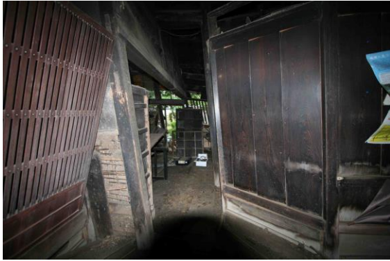
写真 G.5 土間内部、柱が著しく傾斜し建具が外れる
