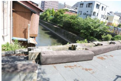
写真 3.6.22 倒壊した石橋の欄干
