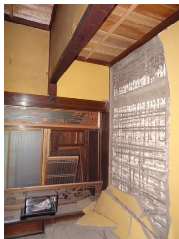
写真 3.2.9 岡本家住宅 トコの壁の崩落
