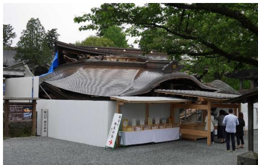
写真 3.3.1 阿蘇神社・倒壊した楼門(参道側)
