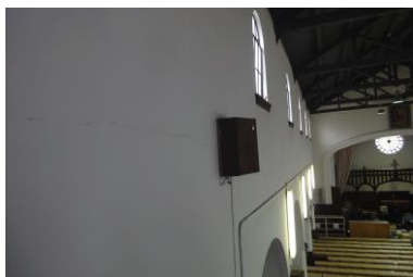
写真 3.5.7 壁に横長のクラック
