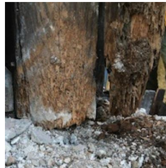
写真 3.6.20 柱への蟻害の影響
