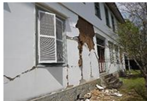
写真 3.3.11 前震による被害状況(背面)
