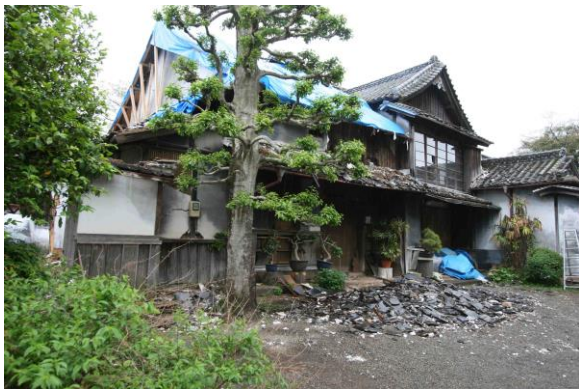
写真 G.3 主屋正面、瓦が落下し土壁も剥落
