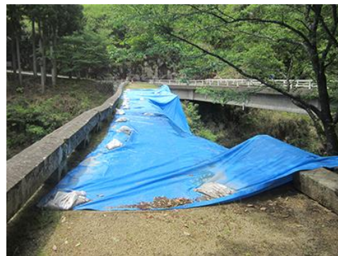
写真 3.3.7 八勢眼鏡橋の崩落(右岸から)
