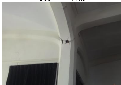
写真 3.5.9 礼拝堂内の梁型や柱型にクラック
