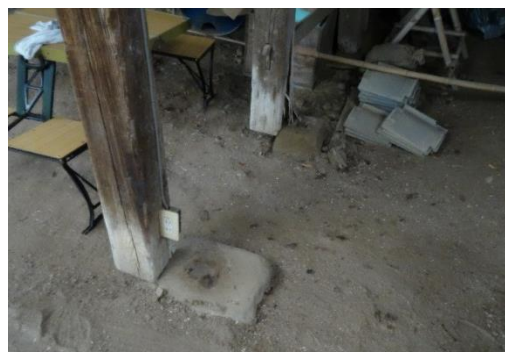
写真 3.2.18 矢野家住宅（本宅）・納屋の柱と礎石のズレ
