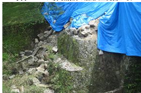
写真 3.3.9 八勢眼鏡橋の崩落(上流側から)
