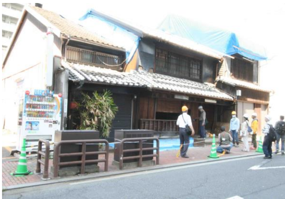
写真 G.11 外観、瓦の落下
