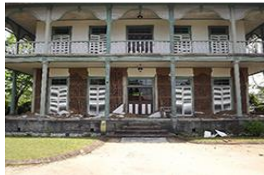
写真 3.3.10 前震による被害状況(正面)
