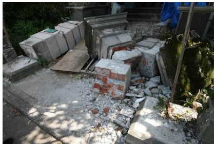
写真 3.6.16 倒壊した煉瓦造の門柱
