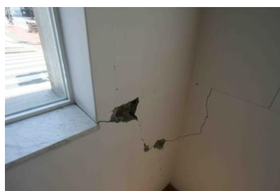
G.15 壁のクラック
