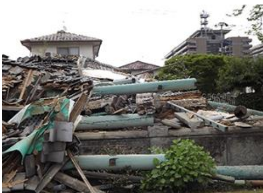
写真 3.3.14 本震で全壊した建物 その1
