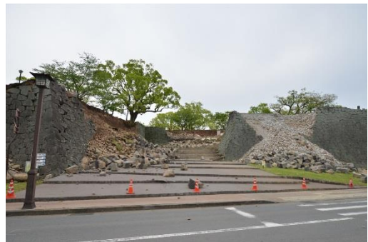
写真 3.1.8 熊本城・二の丸櫓門跡付近
