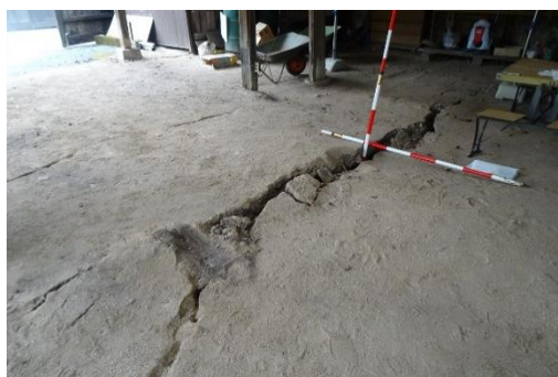
写真 3.2.17 矢野家住宅（本宅）・納屋の亀裂
