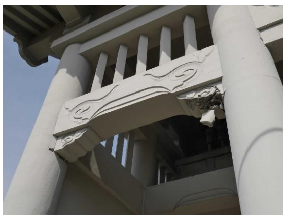
写真3.4.7 本妙寺仁王門・柱頭・中間梁・肘木の破損
