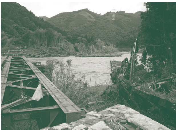
球磨川第二橋梁の被災状況（写真提供：鯨坂徹）
